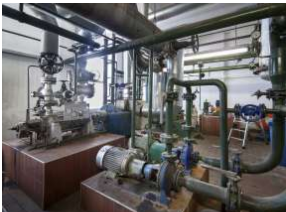
Die vorgeschriebenen zwei unterschiedlich betriebenen Kessel-Speisepumpen . Vorn 2 elektrische Kreiselpumpen, hinten eine Dampfturbopumpe. Foto © Eberhard Lantz
