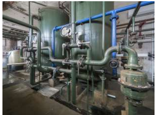
Eine klassische Wasseraufbereitungsanlage Foto © Eberhard Lantz
