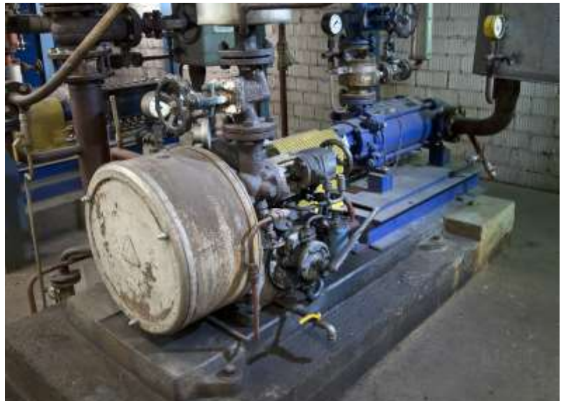
Dampfturbopumpe im Pumpenraum der Zuckerfabrik Warburg Foto © Eberhard Lantz
